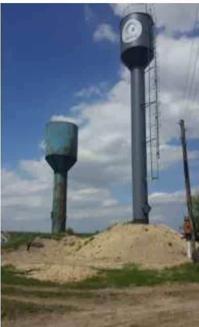
Отсутствуют растяжки с талрепами, краны, задвижки, датчики-реле давления, откосы земляных сооружений не укреплены посевом многолетних трав.
