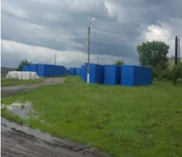
Станции водоподготовки не смонтированы - расположены на территории насосной станции 2-го подъема 4-го водозабора по ул. Корочанская в г. Белгороде.
